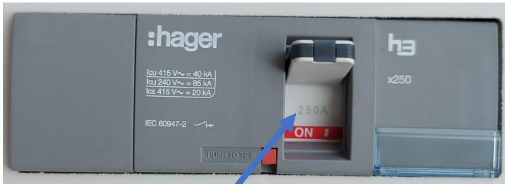
(PIA de 250A) → colocar transformadores de 400 A
